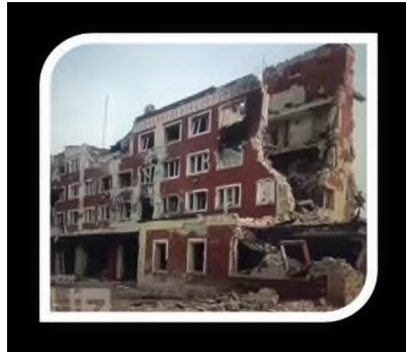
Будівля АРЗ СП м. Рубіжного після обстрілів
